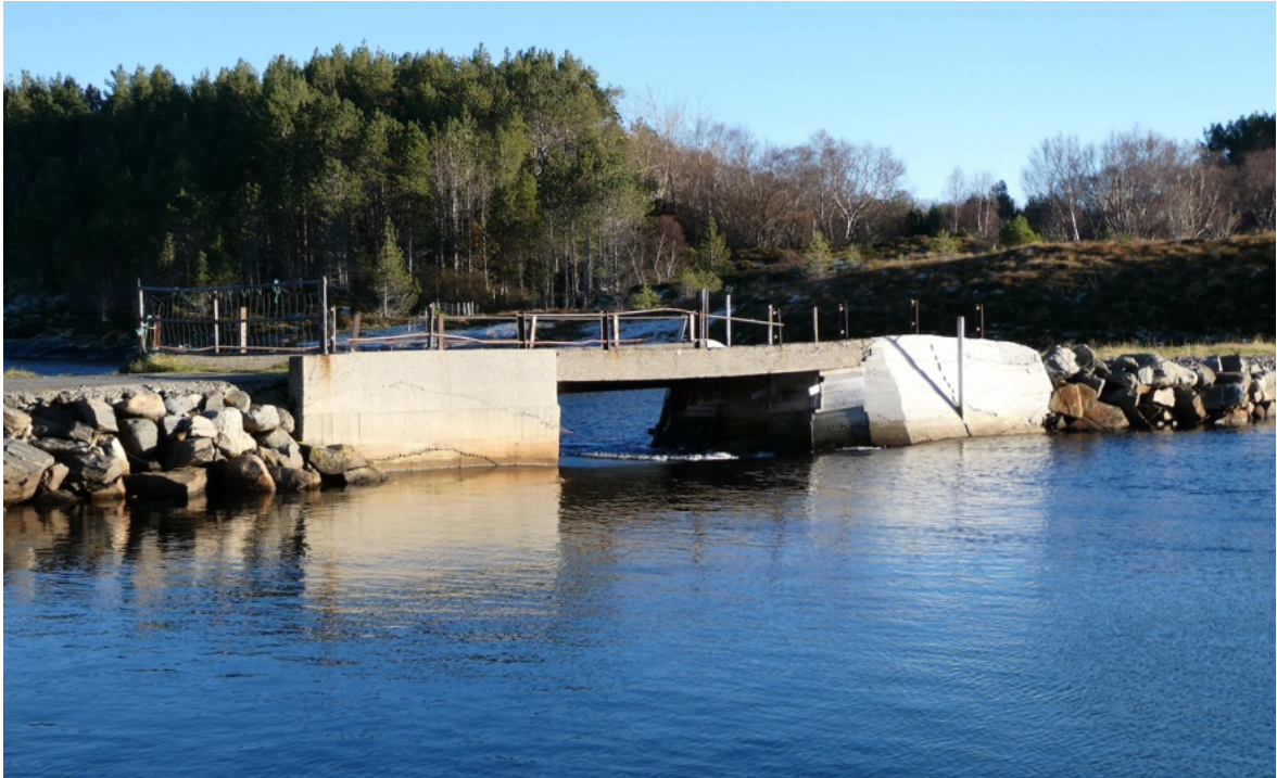
Figur 16. Den indre landbruksbrua ved utløpet av Sandblåstvågen. Løpet er smalt og påvirker vannutskiftningen i våtmarkssystemet vesentlig. Foto: Arnstein Gjeldnes.
