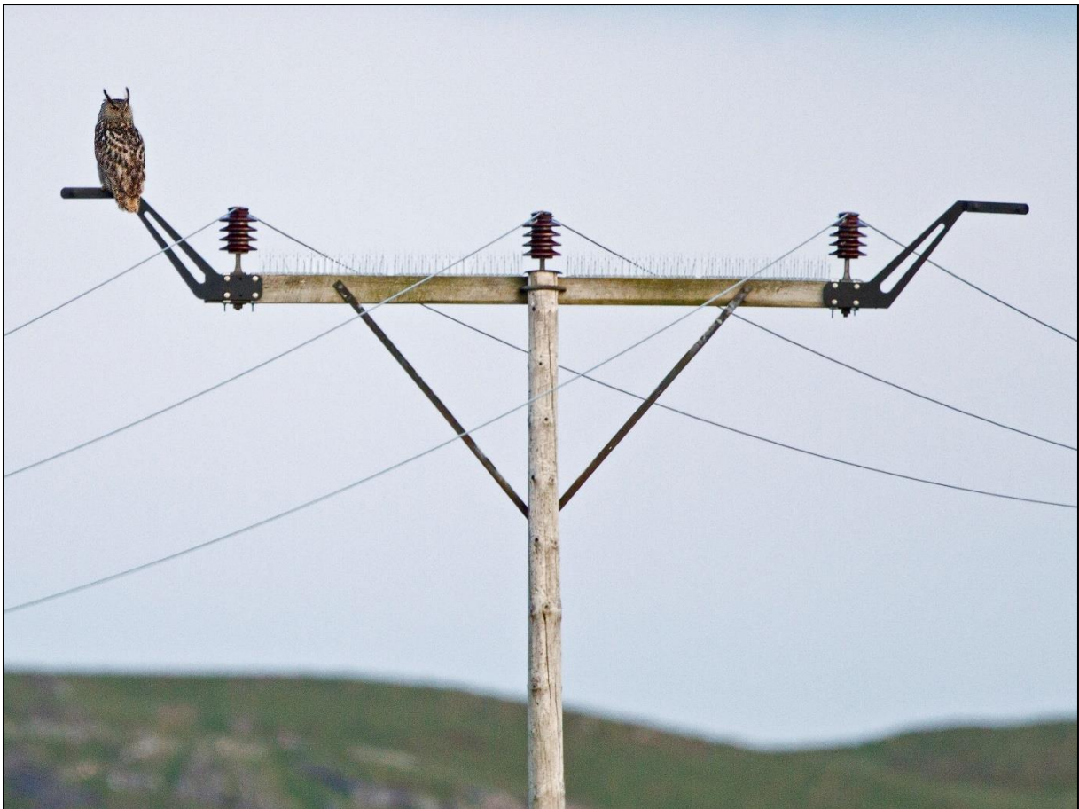
Kraftmast (22 kV) med piggmatte og sittepinne for hubro på Solværøyene i Lurøy i Nordland. Dette er en aktuell løsning for å unngå elektrokusjonsdrept hubro, og spesielt i fuktige og kystnære områder der plastbeskyttelse gir økt korrosjonsrisiko. Foto: Karl-Otto Jacobsen
