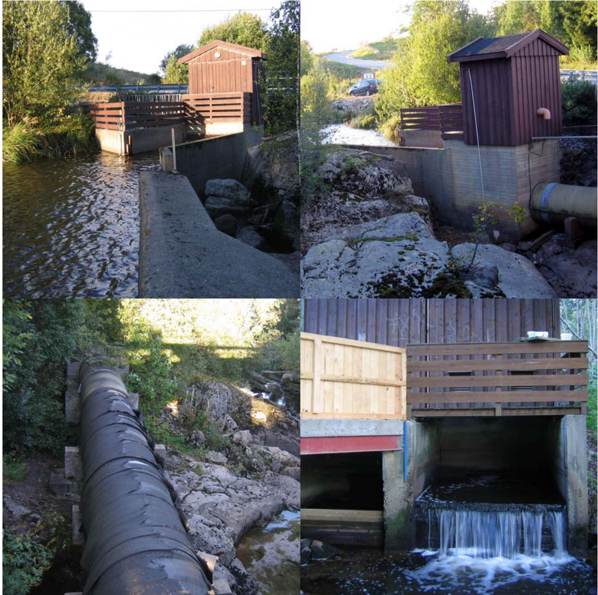
Figur 2.1. Lite kraftverk ved Fossum, Gjermåa, Akershus. Øverst vises inntaksdammen sett ovenfra og nedenfra, og under rørgaten med tilnærmet tørrlagt elveleie samt kraftverksbygningen med utløp. Fotografert 3. september 2007 av Trond Øigarden.
